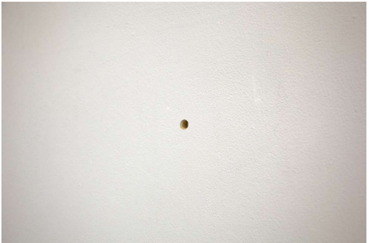
Détail de l'un des deux trous dans le mur
